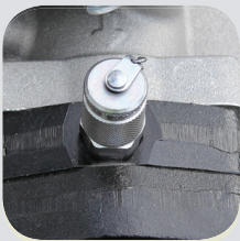
Porta acesso de amostragem do óleo durante operação
