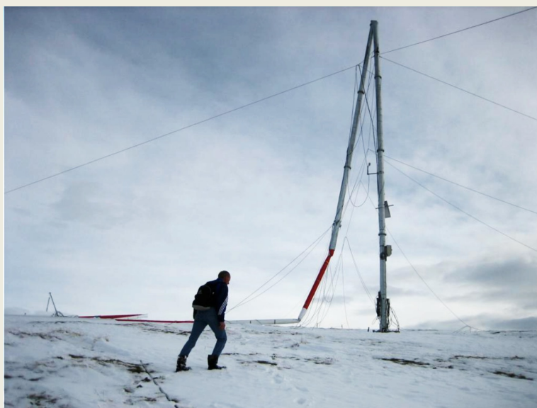
Le mât de mesures sur le Schwyberg s'effondrait en novembre 2007 à cause du poids de la glace © Enco Energy Consulting
