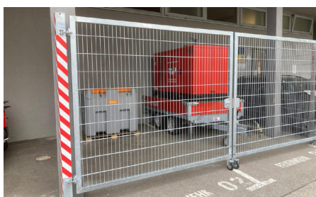
Notstromaggregat in Kaltenleutgeben
