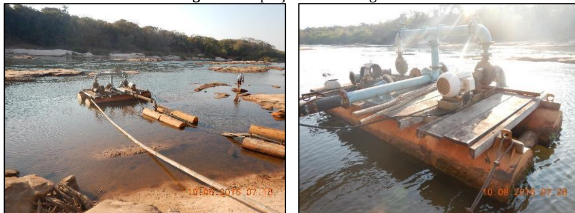
Figura 3. Captação no rio Araguaia
