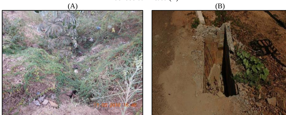
Figura 8. Erosão ocasionada pela ausência de dissipadores no final da galeria de água pluvial (A), boca de lobo danificada (B)
