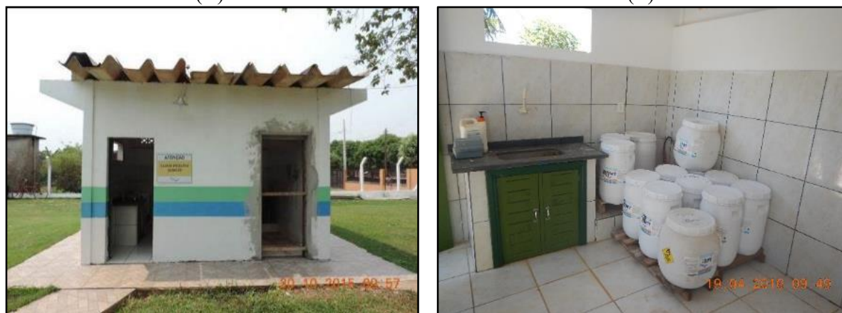
Figura 4. Casa de química (A) e armazenamento do hipoclorito de cálcio (B)
