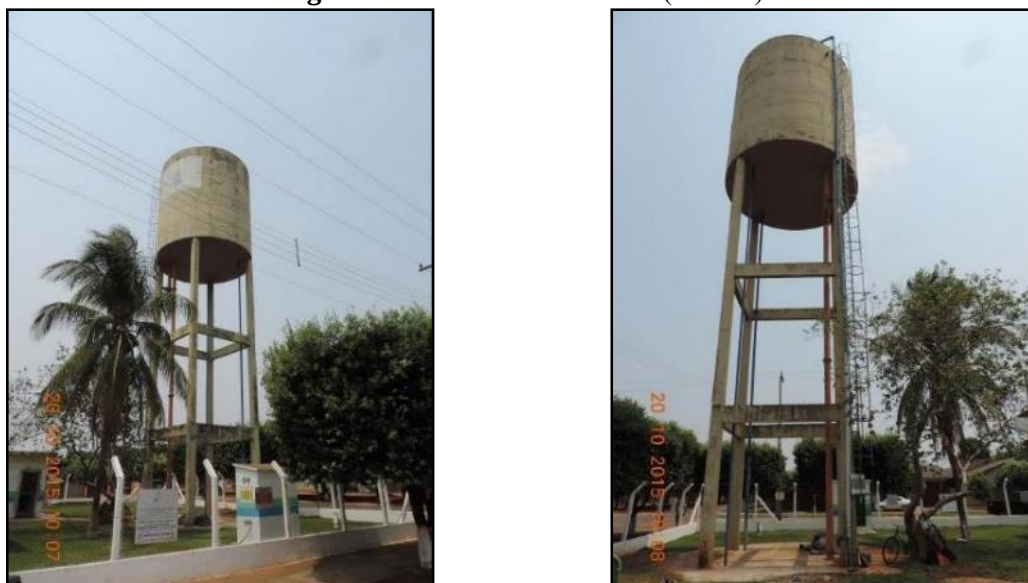
Figura 5. Reservatório REL-01 (150 m 3 )
