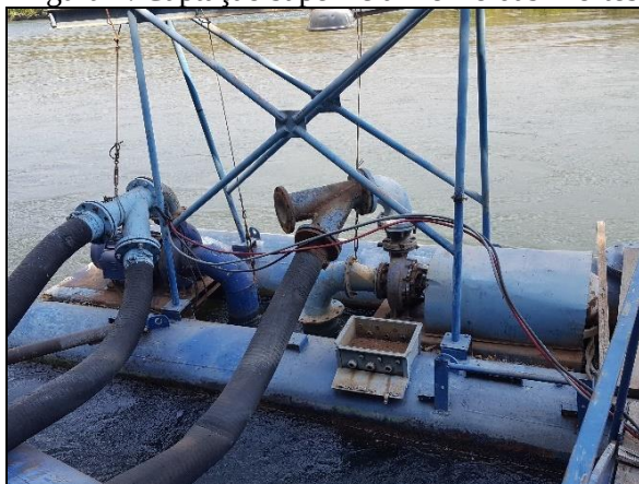
Figura 2. Captação superficial no rio das Mortes
