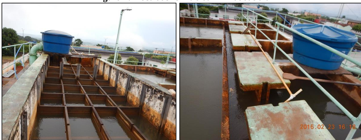
Figura 4. Floculador e filtro da ETA de Jaciara
