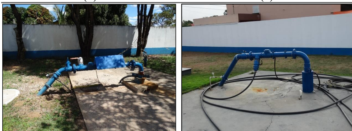
Figura 2. Poços (A) PT-04 e (B) PT 12 que abastecem a área urbana de Nova Mutum
