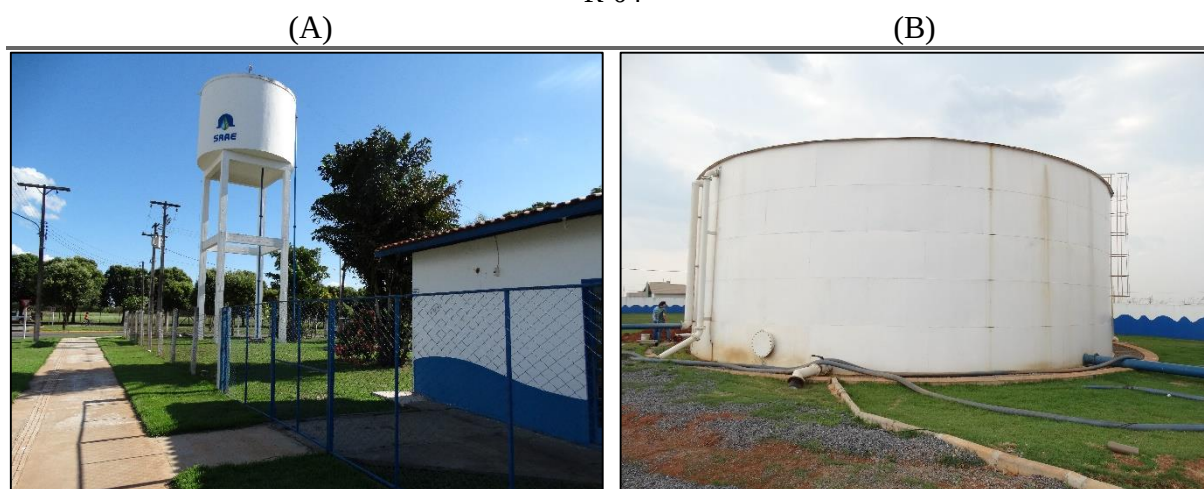
Figura 3. (A) Reservatório ativo elevado de concreto- R-01 (B) Reservatório ativo apoiado metálico- R-04
