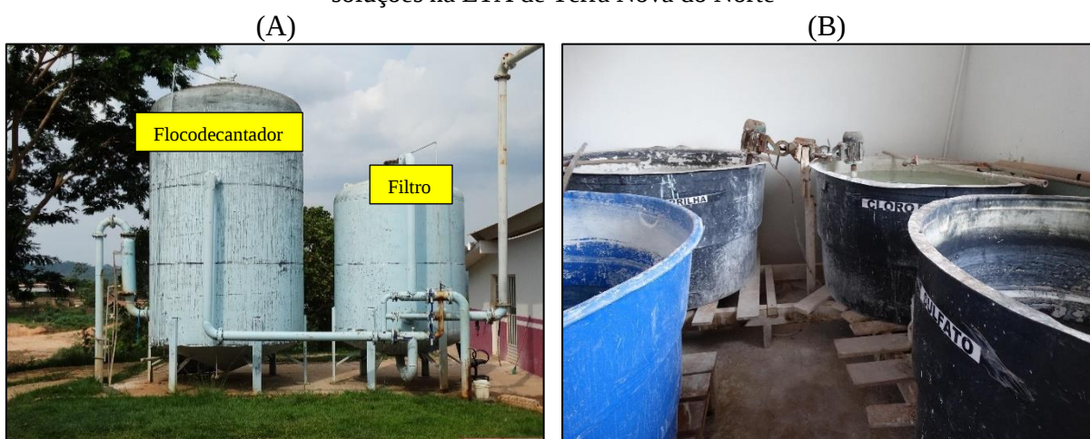
Figura 3. (A) Visão geral da ETA de Terra Nova do Norte (B) Dispositivos onde são preparadas as soluções na ETA de Terra Nova do Norte
