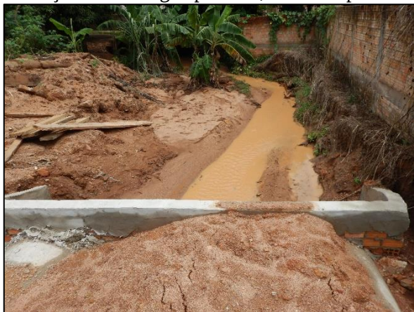
Figura 5. Lançamento de água pluviais, sem dissipador de energia
