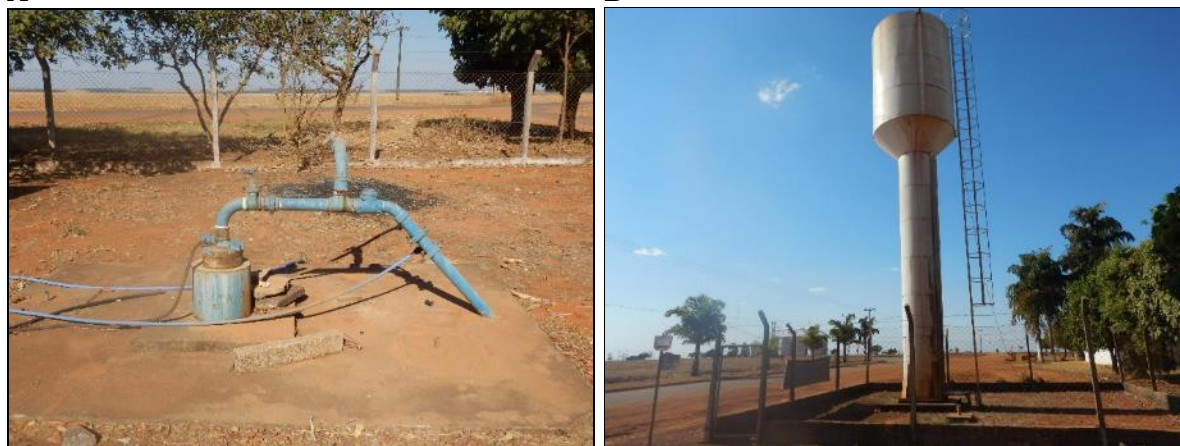
Figura 19. Vista exterior do poço tubular PT-01 (A) e reservatório metálico elevado (B), Groslândia
