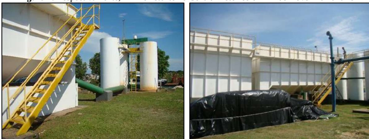
Figura 4. Respectivamente, ETA existente no Centro Histórico e ETA de Novo Diamantino
