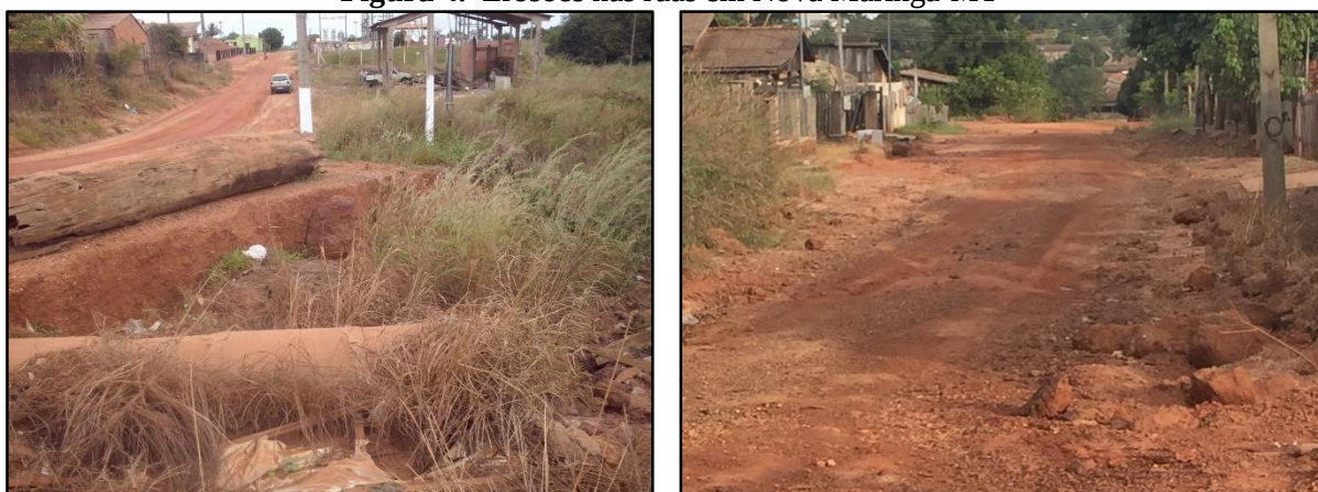
Figura 4. Erosões nas ruas em Nova Maringá-MT
