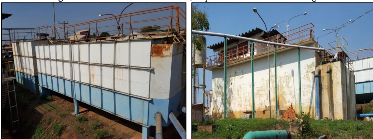
Figura 3. ETA metálica e de concreto, respectivamente de Barra do Bugres
