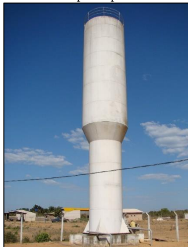
Figura 12. Reservatório principal do distrito de Japurana
