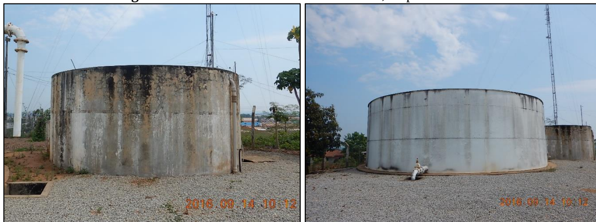
Figura 4. Reservatório 01 e Reservatório 02, respectivamente
