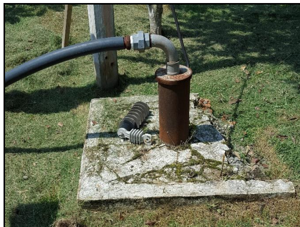
Figura 3. Captação subterrânea por poço tubular em Novo Mundo
