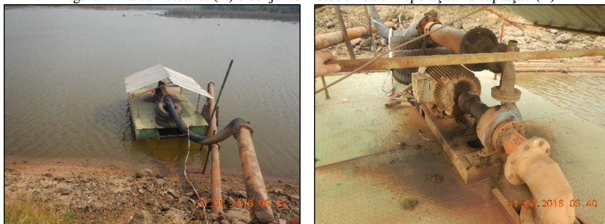
Figura 4. Balsa flutuante (A) e conjunto motobomba em operação na captação (B)
