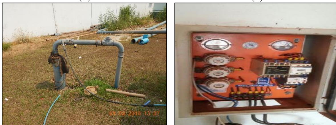
Figura 5. Vista do poço PT-01(A) e quadro de comando do poço (B)
