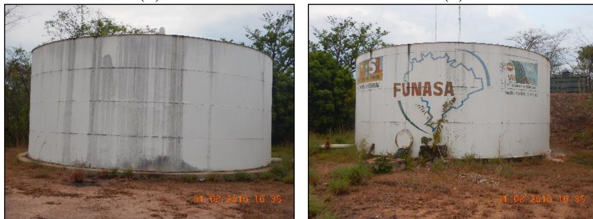
Figura 6. Reservatórios ativos no sistema de abastecimento: RAP-01 (A), RAP-02 (B) e REL-01 (C)
