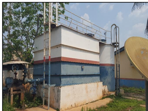
Figura 4. ETA metálica com capacidade para tratar 50 m 3 /hora
