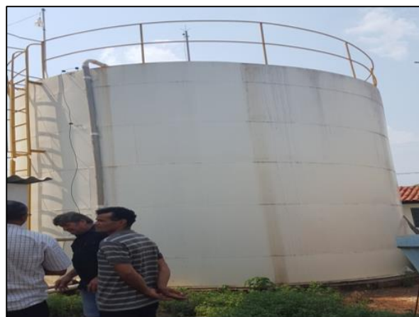
Figura 6. Reservatório apoiado (RAP-01) de 150 m³ na área da ETA
