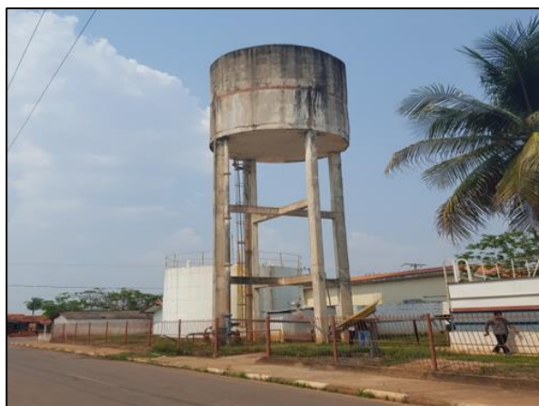
Figura 5. Reservatório elevado (REL-01) de 100 m³ na área da ETA
