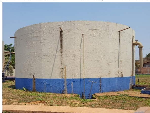
Figura 4. Reservatório RAP-1 de 400,0 m 3 na área da ETA
