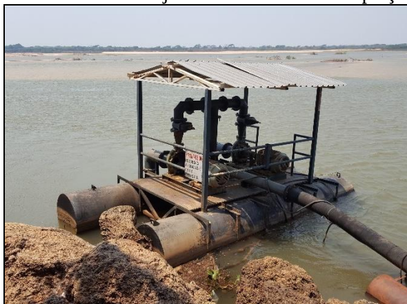
Figura 2. Balsa metálica com os conjuntos motobomba de captação no rio Araguaia
