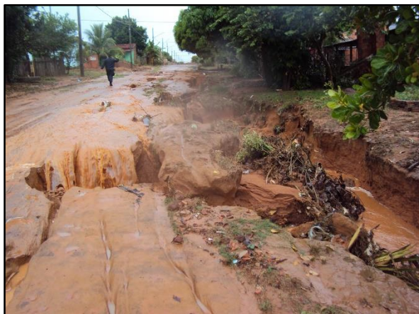
Figura 5. Erosão na Rua 11 no Bairro Jardim Itamarati- Nova Olímpia-MT
