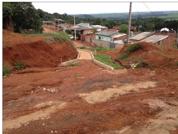
Figura 5. Rua Rui Barbosa com grande erosão
