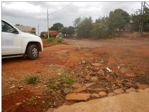
Figura 4. Erosão na rua Francisco Carvalho
