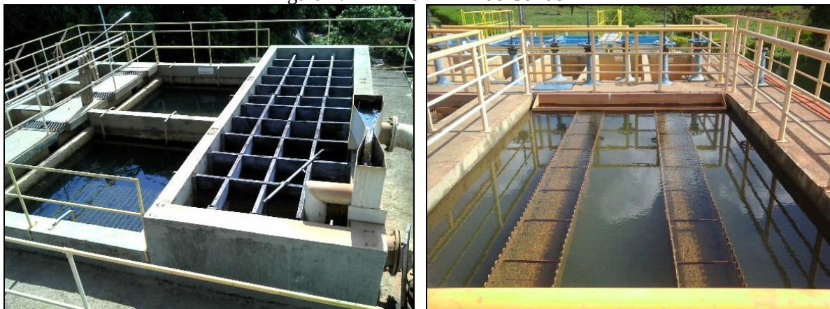
Figura 4. ETA 1 e ETA 2 de Colíder
