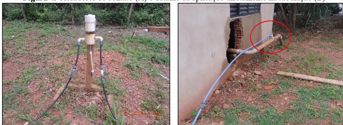
Figura 4. Cloradores de contato (A) e detalhe da aplicação diretamente na tubulação (B)
